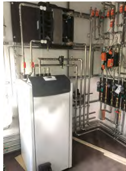
Abb. 02: Wärmepumpe im Energiecontainer [Foto: Ulrich Lüdersen]
