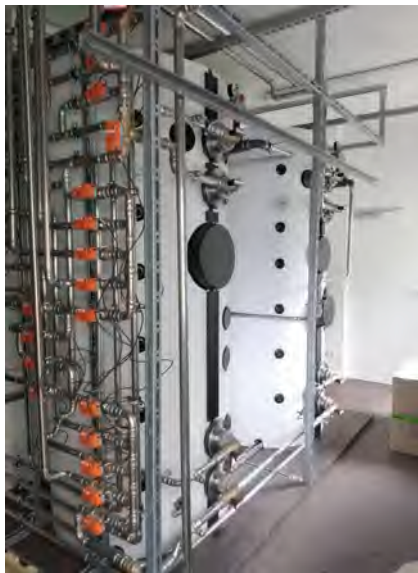
Abb. 01: Nieder- und Hochtemperaturspeicher [Foto: Ulrich Lüdersen]
