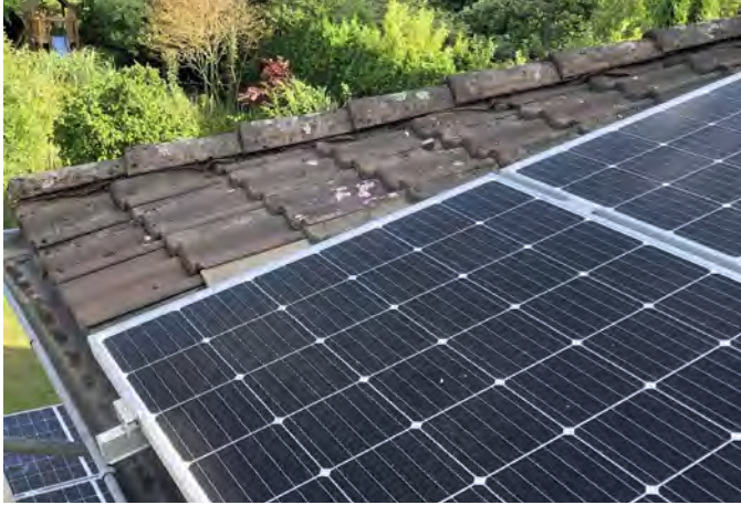
Abb. 01: Teil der PV-Anlage auf dem Hauptdach
