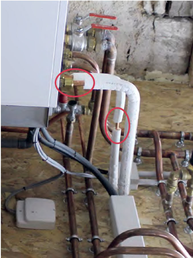
Illustration 2: Isolation incomplète du réseau frigorifique [©AQC]
