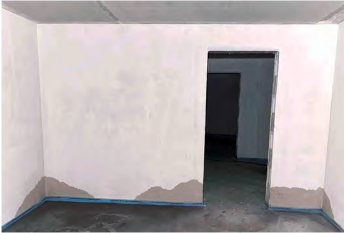
Abb. 02: Durchfeuchtung am Fußpunkt einer Kellerinnenwand
