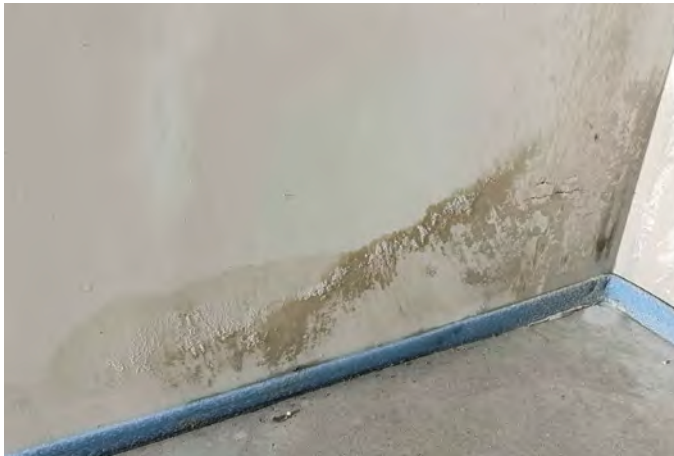
Abb. 07: Kellerwand mit Wasserrändern und Salzausblühungen
