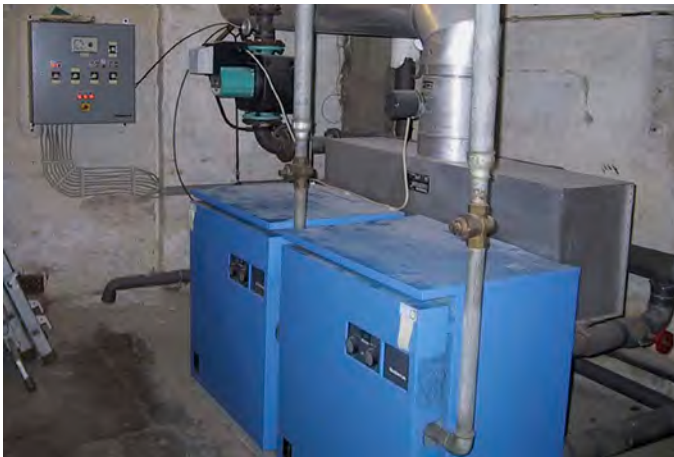
Abb. 02: Bestehende Heizungsanlage mit Konstanttemperaturkessel
