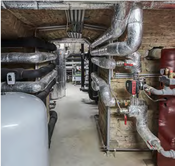
Abb. 02: Hautechnikzentrale im Bestandskeller [Foto: Kurt Hoerbst]
