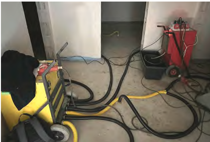
Abb. 05: Trocknungsanlage in einem Kellerraum
