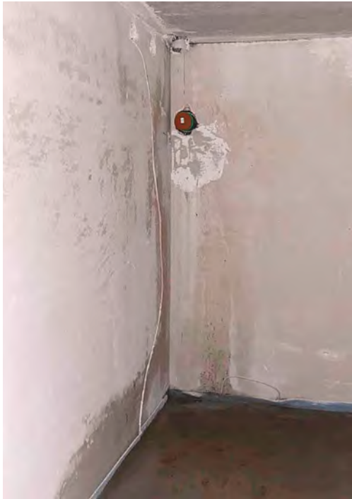
Abb. 01: Kelleraußenwand mit Wasserablaufspuren unterhalb einer Wanddurchdringung
