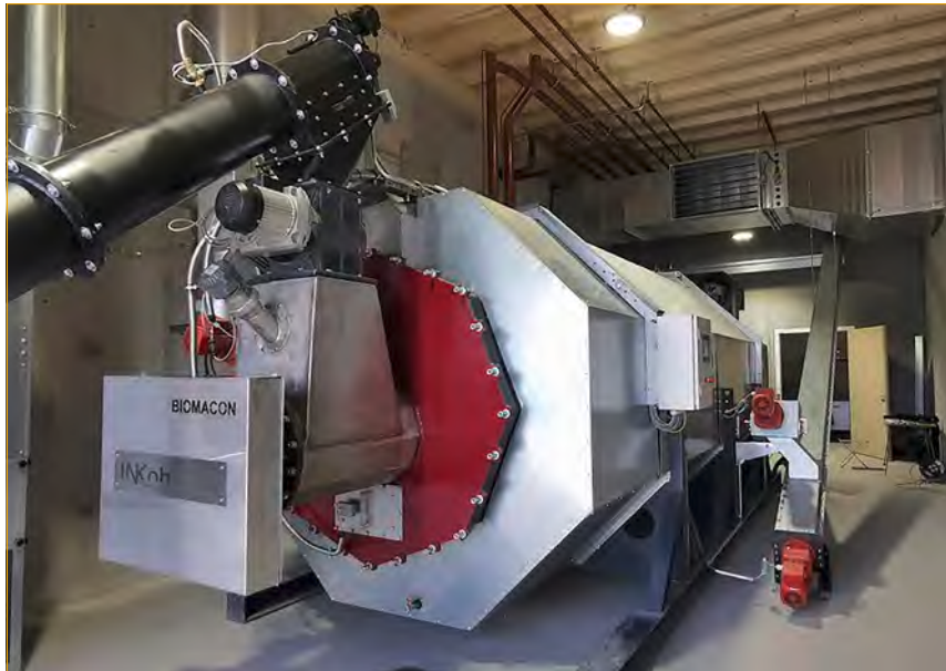
Abb. 01: Biomacon Pyrolyseanlage [Foto: Zindel United]
