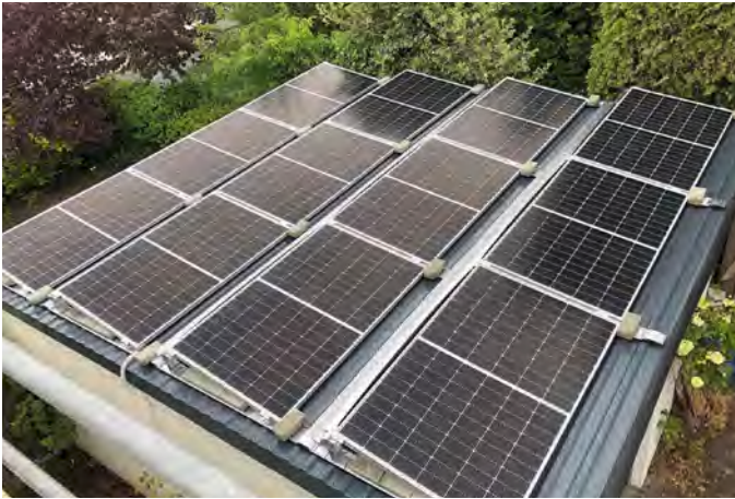
Abb. 03: PV-Anlage auf dem Garagendach
