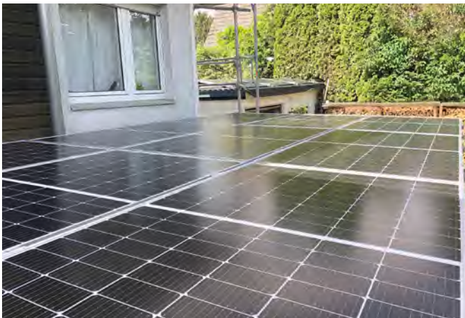
Abb. 02: PV-Anlage auf einem Nebendach
