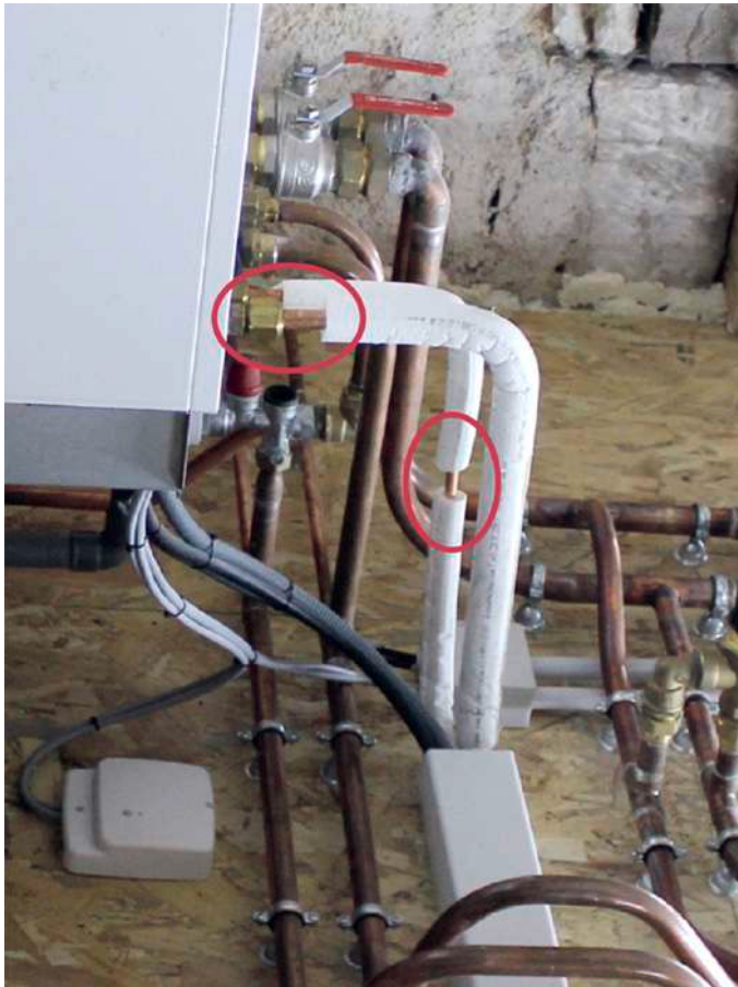
Abb. 02: Unvollständige Dämmung des Leitungssystems [Foto: AQC]
