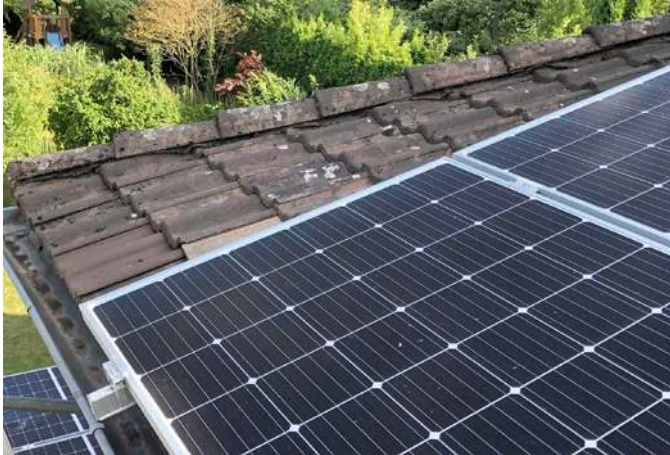
Abb. 01: Teil der PV-Anlage auf dem Hauptdach
