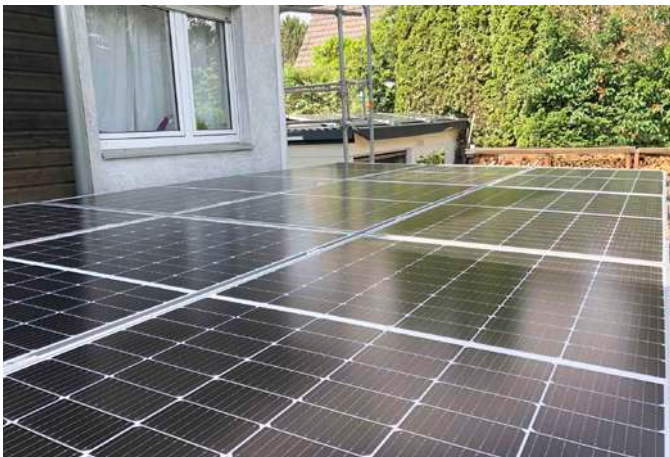
Abb. 02: PV-Anlage auf einem Nebendach
