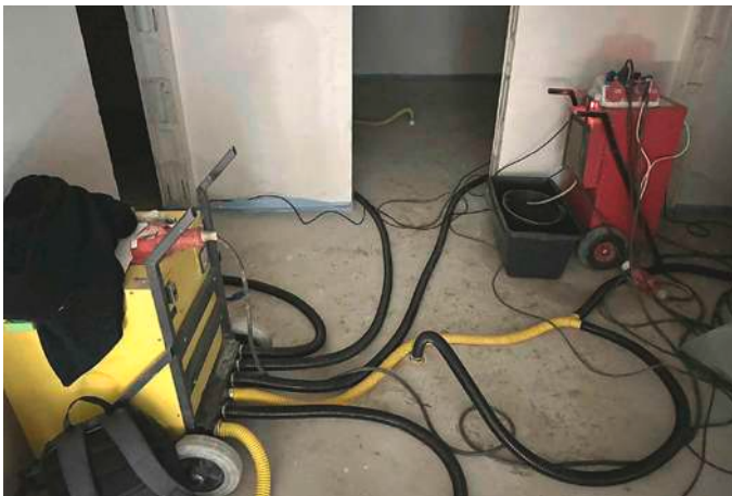
Abb. 05: Trocknungsanlage in einem Kellerraum
