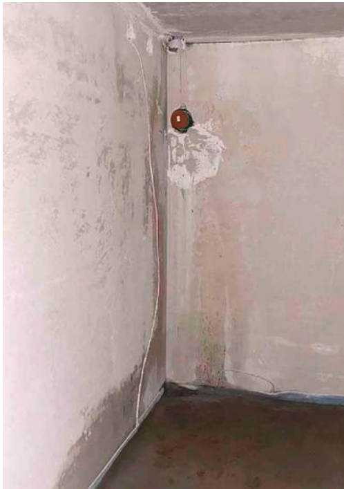
Abb. 01: Kelleraußenwand mit Wasserablaufspuren unterhalb einer Wanddurchdringung
