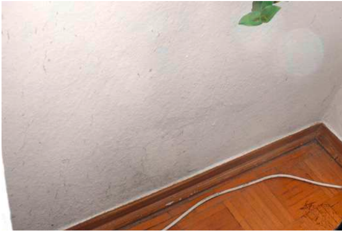
Abb. 02: Innenfläche einer Außenwand mit Schimmelpilzbefall
