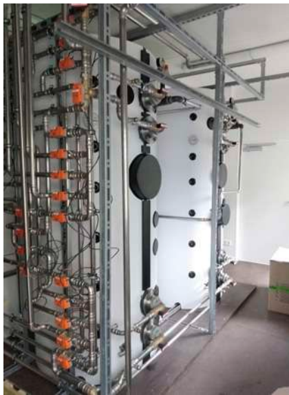
Abb. 01: Nieder- und Hochtemperaturspeicher [Foto: Ulrich Lüdersen]
