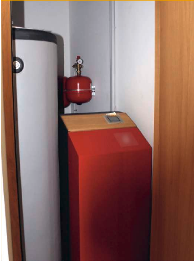
Abb. 01: Um die Entfernung zwischen der Wärmepumpe und der Außeneinheit zu begrenzen, wurde der Technikraum an einem anderen Ort als ursprünglich geplant untergebracht. Der neu gewählte Raum ist kleiner und erfordert daher, dass die Anlagenkomponenten stark verdichtet eingebaut werden. Es ist eine Trittleiter erforderlich, um Anlagenteile auf der Rückseite der Wärmepumpe zu erreichen. [Foto: AQC]
