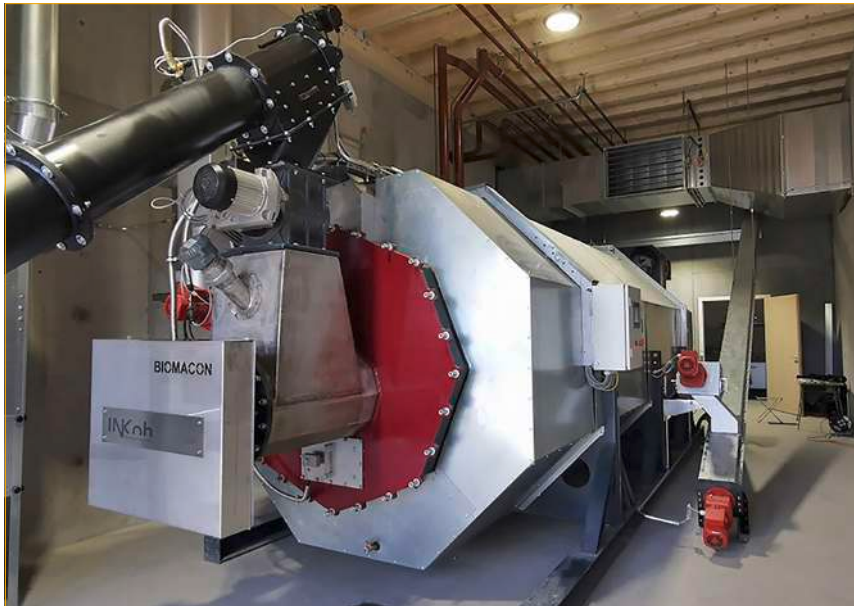
Abb. 01: Biomacon Pyrolyseanlage [Foto: Zindel United]
