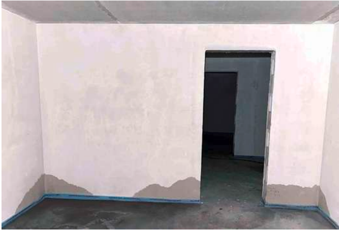
Abb. 02: Durchfeuchtung am Fußpunkt einer Kellerinnenwand
