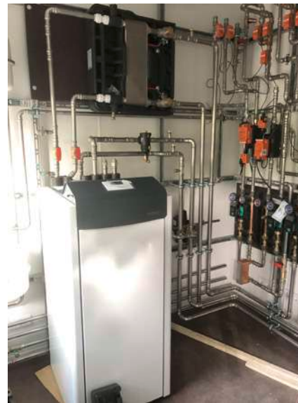
Abb. 02: Wärmepumpe im Energiecontainer [Foto: Ulrich Lüdersen]
