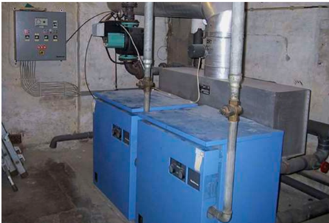
Abb. 02: Bestehende Heizungsanlage mit Konstanttemperaturkessel
