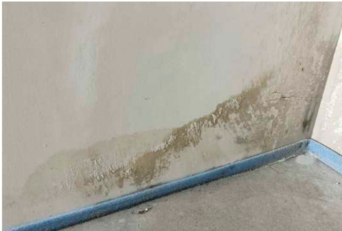
Abb. 07: Kellerwand mit Wasserrändern und Salzausblühungen
