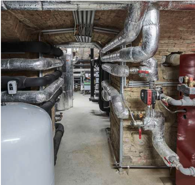
Abb. 02: Hautechnikzentrale im Bestandskeller [Foto: Kurt Hoerbst]
