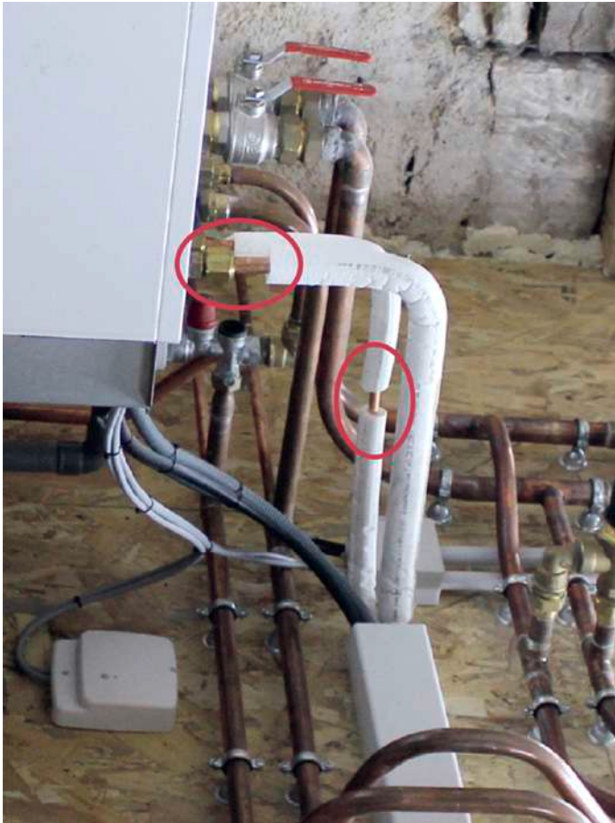
Illustration 2: Isolation incomplète du réseau frigorifique [©AQC]
