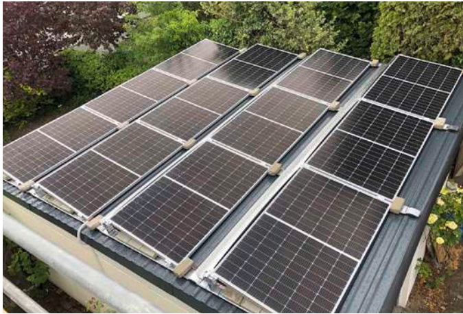
Abb. 03: PV-Anlage auf dem Garagendach
