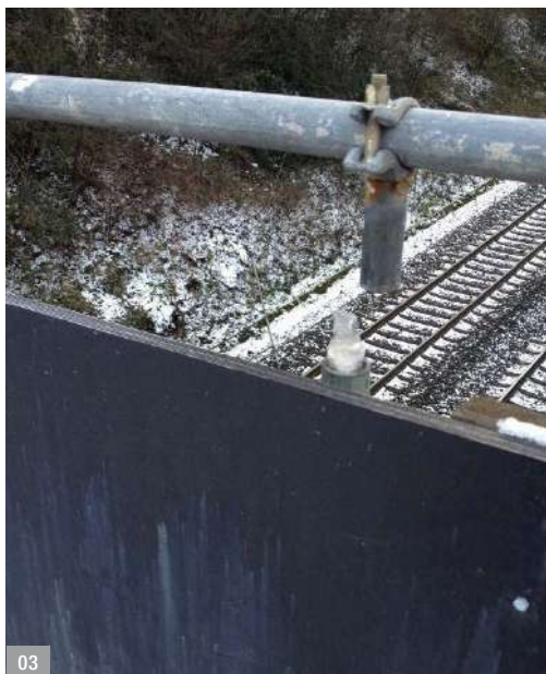
Abb. 03: Eisbildung durch gefrorenes Niederschlagswasser in einer Gerüststange
