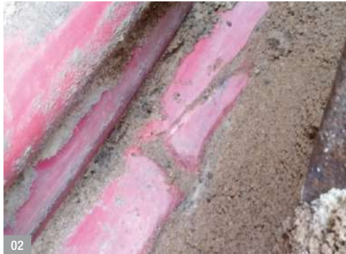
Abb. 02: Beschädigter Kabelmantel eines Hochspannungskabels
