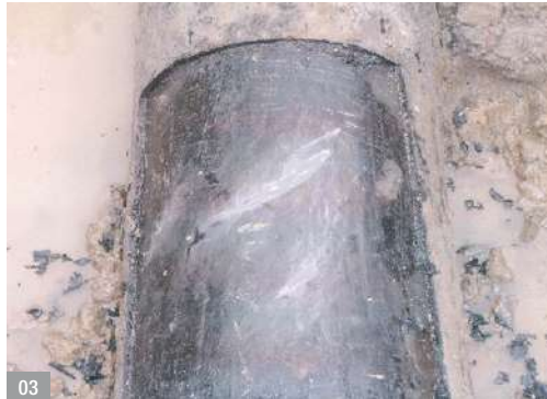
Abb. 03: Beschädigte Gastransportleitung, partiell entfernter Leitungsmantel
