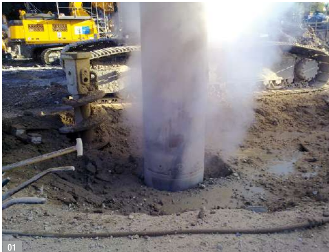
Abb. 01: Aufsteigender Wasserdampf aus einer beschädigten Fernwärmeleitung (Symbolbild)
