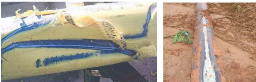
Abb. 01: Leitungskontakte durch unterschiedliche Baggertypen
