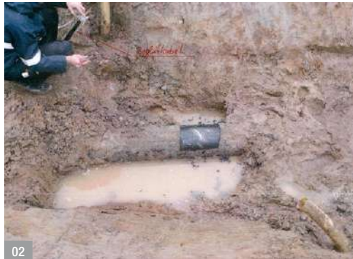
Abb. 02: Gerissenes Begleitkabel und freigelegte Gastransportleitung
