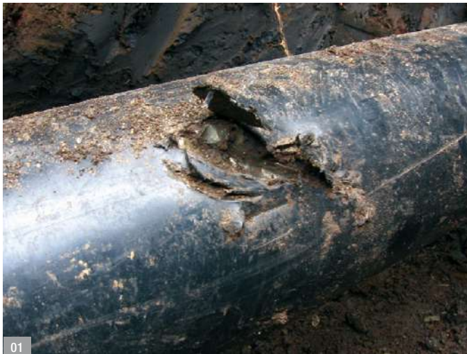
Abb. 01: Bei Tiefbauarbeiten beschädigte Gastransportleitung (Symbolbild)
