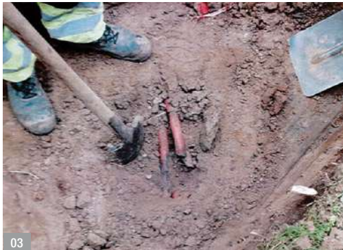
Abb. 03: Durch den elektrischen Kurzschluss verbrannte Kabel(-mäntel)
