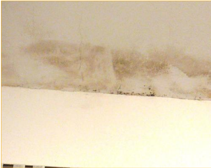
Abb. 03: Schimmelpilzbefall im Anschlussbereich Außenwand-Decke
