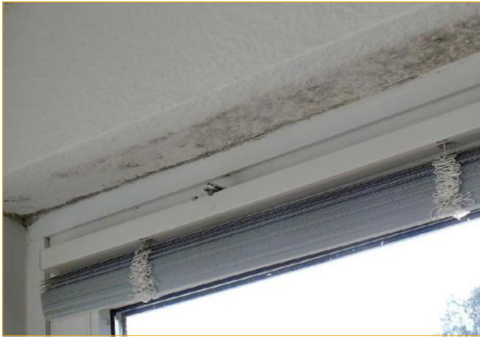
Abb. 01: Schimmelpilzbefall im Bereich der Fensterlaibungen
