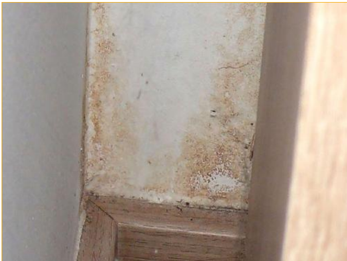
Abb. 03: Schimmelpilzbefall in der Raumecke, Aufnahme nach Rückbau der Küchenzeile
