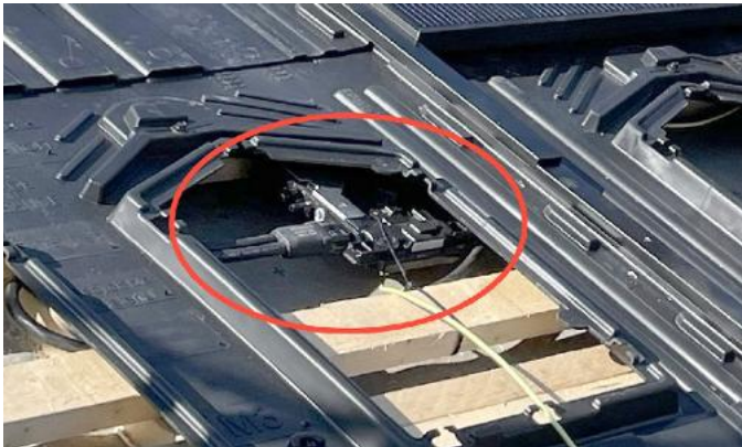
Abb. 02: Foto der rückseitigen Wechselrichterinstallation [Foto: Holz- und Energiewerk GmbH]
