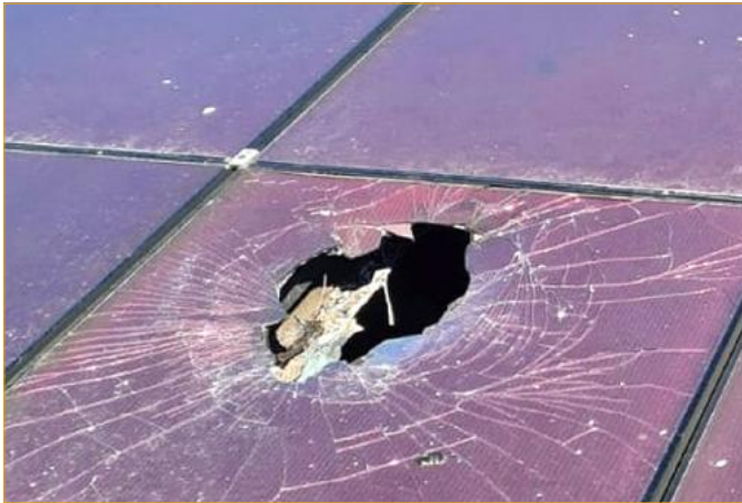
Abb. 01: Durch starke Hitzeeinwirkung beschädigtes PV-Modul
