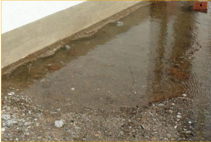
Abb. 01: Aufgestautes Niederschlagswasser vor dem Neubau
