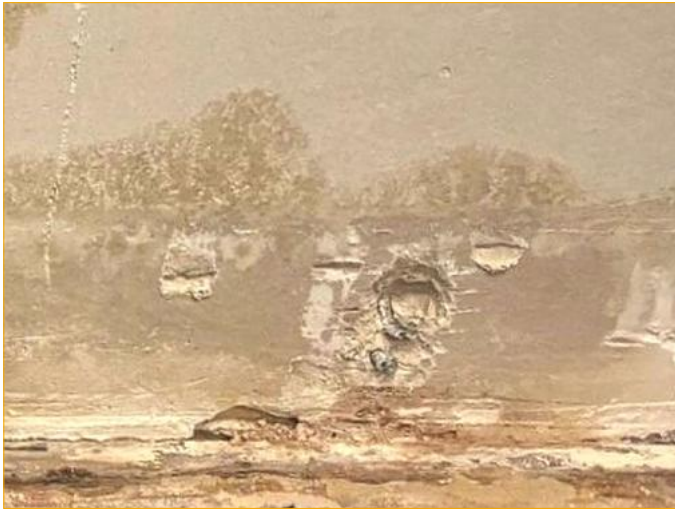
Abb. 02: Durchfeuchtete Wand im Fußpunktbereich
